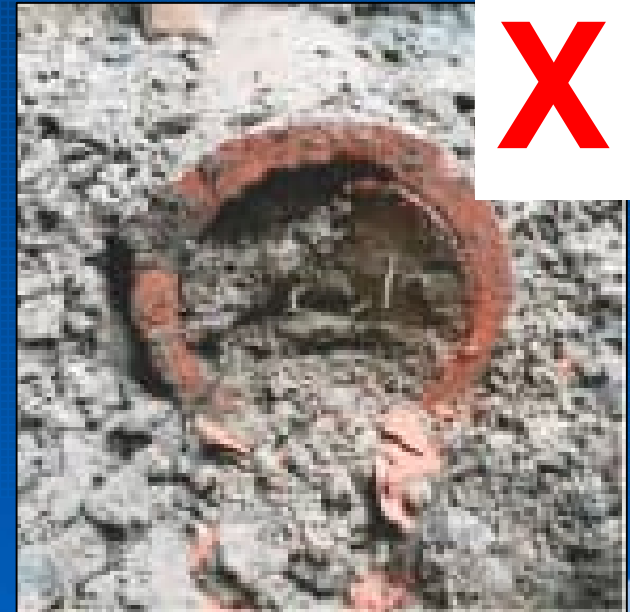
Drain de fondation obstrué
